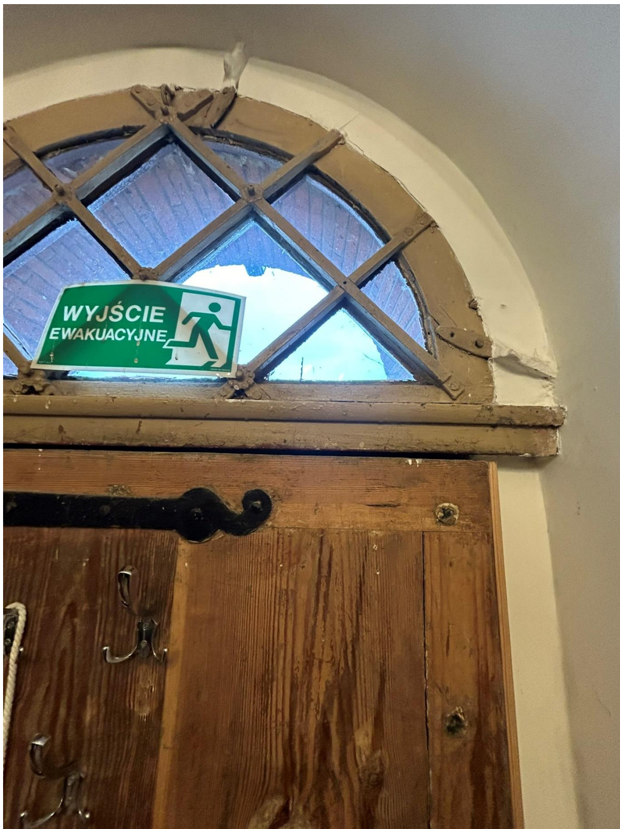
Zniszczenia- drzwi częściowo oczyszczone z farb
