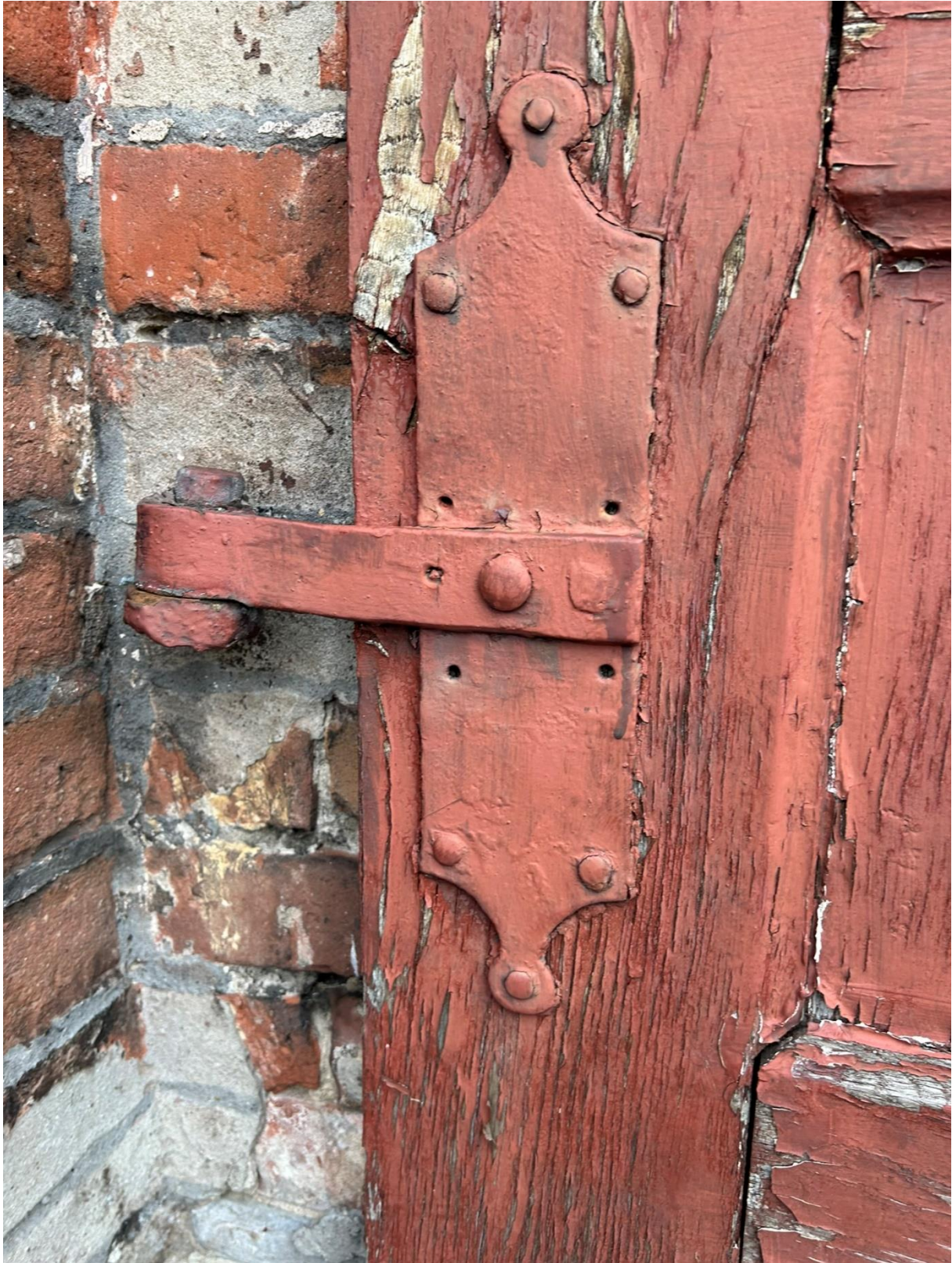
Drzwi z zewnątrz-zniszczenia
