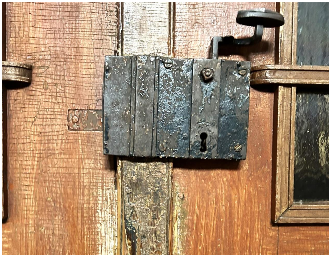
Klamka drzwi do kruchty z widocznymi produktami korozji
